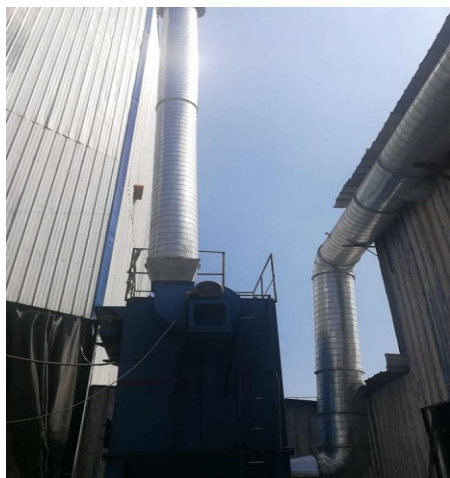
沥青上料口排气筒
