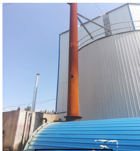
燃油锅炉排气筒
