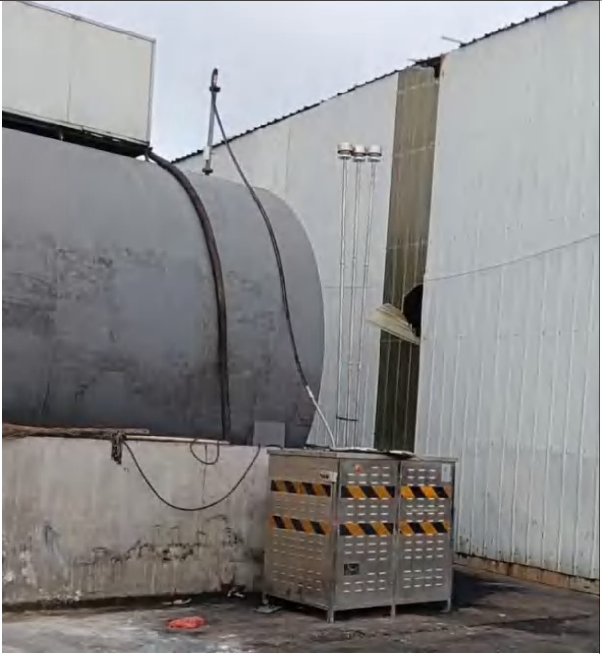
储罐呼吸气排气筒
