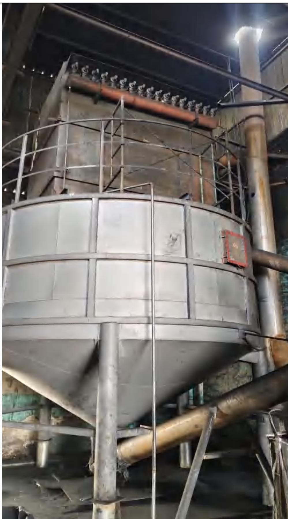
高效脉冲除尘器+DA002 排气筒
