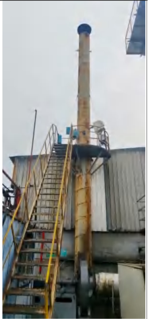
废气处理装置及 15m 高 DA001 排气筒
